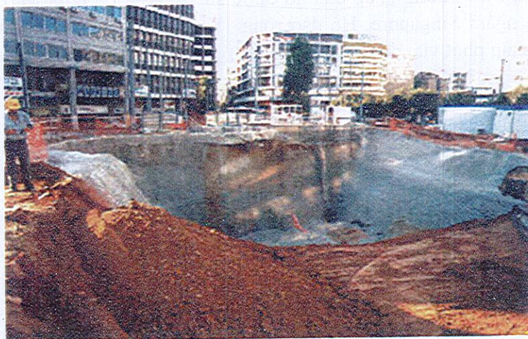
Hình XI.4: Sập hầm đường tàu điện ngầm tại Thủ đô Athens, Hy Lạp, năm 2008 (CEDD 2008) [7].
