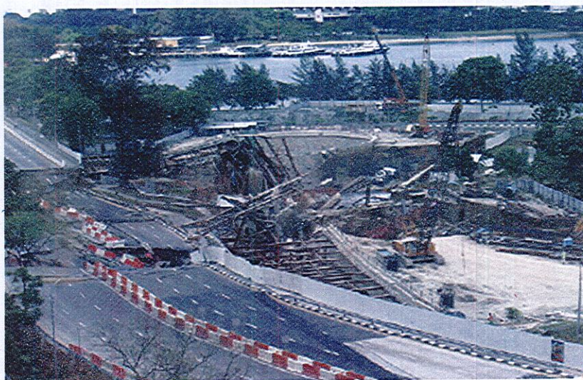
Hình XI.3: Sập hầm đường tàu điện ngầm (MRT) tại Singapore, năm 2004 [7, 54].
